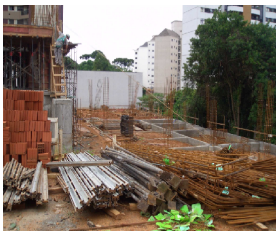
Figura 2 – Falta de organização no canteiro Fonte: Os autores
